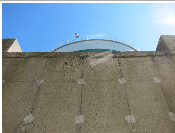
Billede nr. 3: Overgang til den store tankgård, set nedfra (billedet er taget fra den store tankgård).
