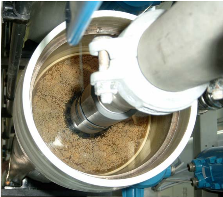
Figur 14.4. Ultrafiltreringsanlæg med hulfibermembraner til behandling af svømmebadsvand
