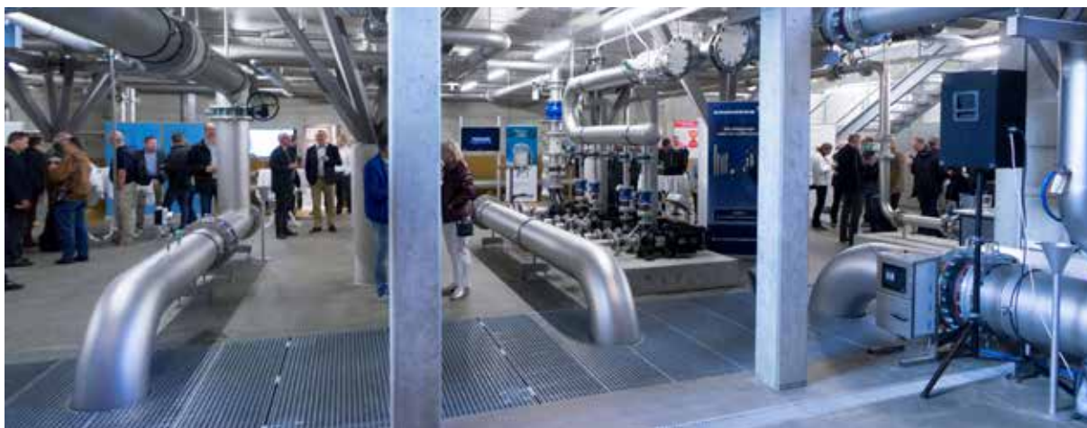
Trulbjergværket, Aarhus Vand
