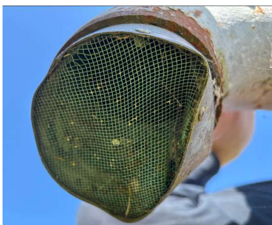
Insektnet udluftningsrør på rentvandstank
