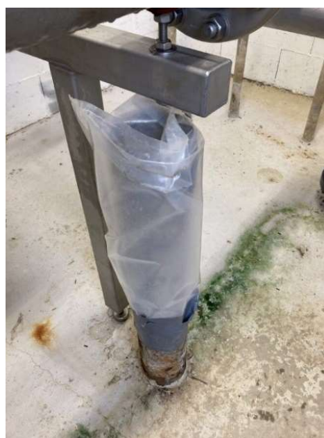
Ukendt rørstump ned i rentvandstank
