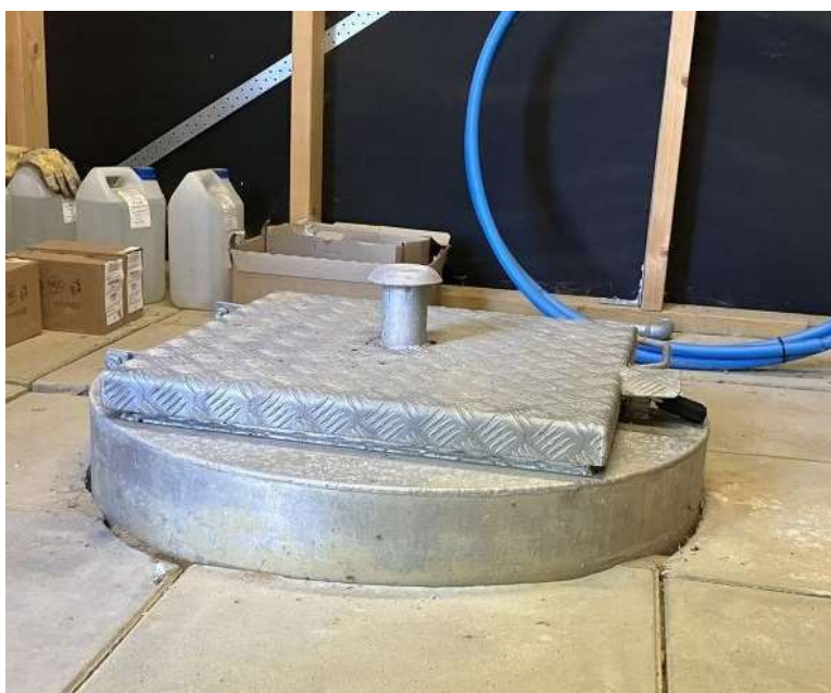
Rentvandstank. Blev ikke åbnet på tilsyn grundet manglende rengøring
