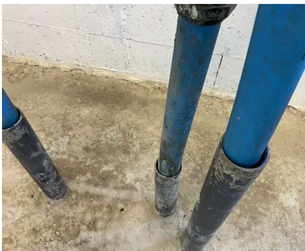
Rør ned i rentvandstank. Ukendt hvordan indføringen er udført – om der er direkte åben forbindelse ned i tanken mellem "flange" og rør. Skal afklares ved inspektion.
