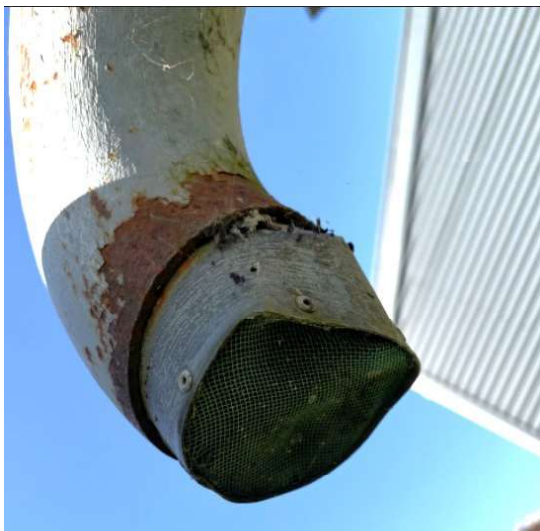
Udluftning på rentvandstank, som er på vej af
