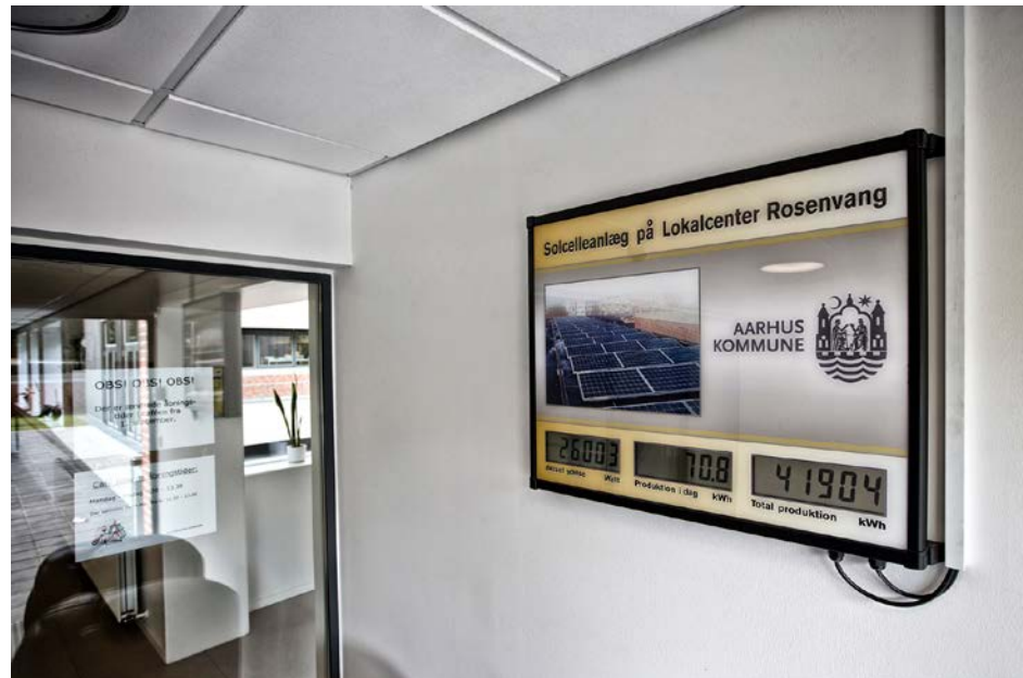
Foto: Infotavle i vindfang der viser produktionen af solenergi på Lokalcenter Rosenvang.
