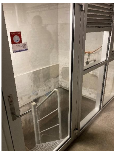
Adgang gl. rentvandsbeholder. Næste kontrol 2027
