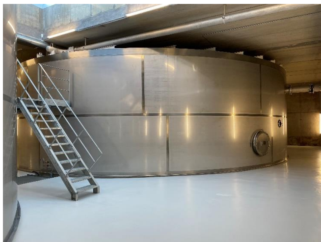
Rustfri stålbeholder på 780 m 3
