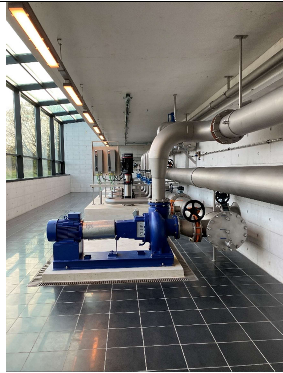
Skyllepumpe og udpumpning
