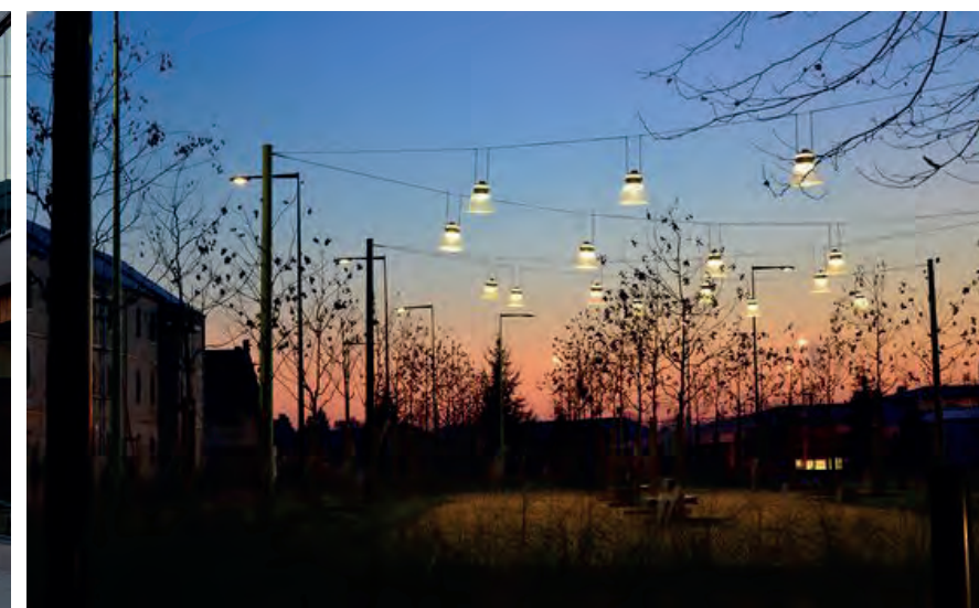
Kombination af vejbelysting på master og wireophængt armatur, hvor også selve armaturet er "lysende".
