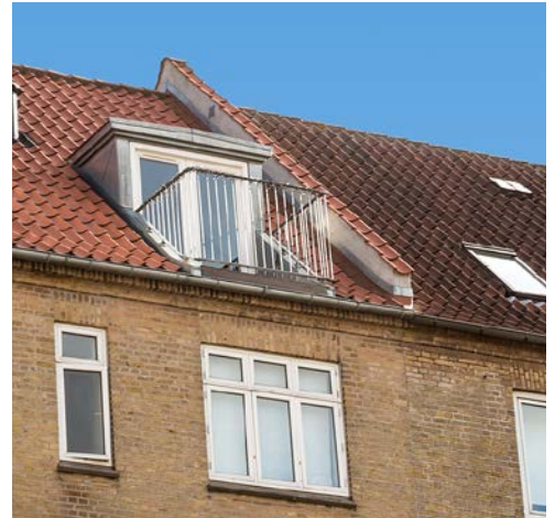
Foto: Tagterrasse. Størrelsen på udskæringen i taget tilpasset tagfladen og facadens vinduespartier.
