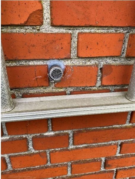
Udluftningshul i klimaskærm med insektnet
