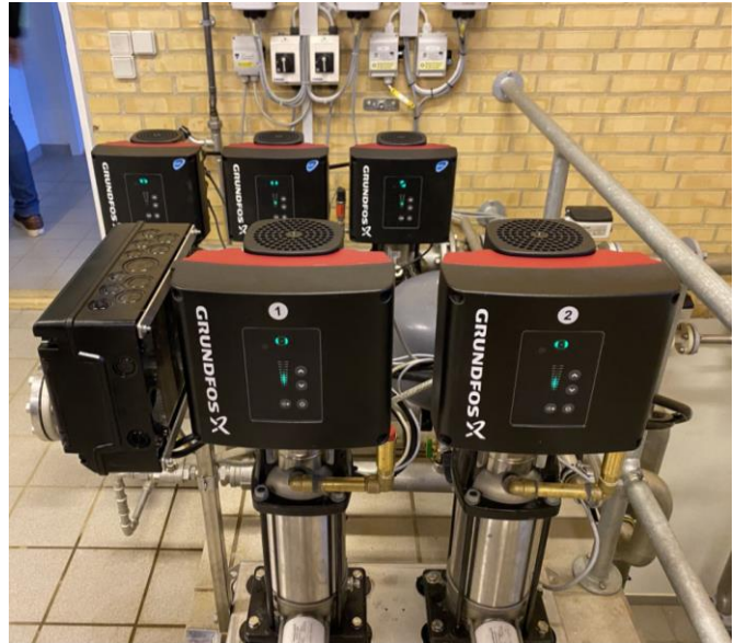
Vorrevej 28C udpumpningsanlæg
