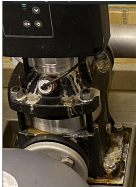
Vorrevej 28C pumpe med utæthed
