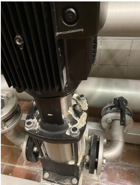
Vorrevej 2 Pumpe til udpumpning med mindre utæthed
