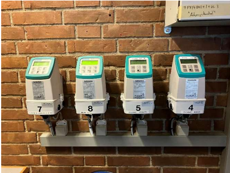
Der er flowmålere for de fire linjer på kontoret.
