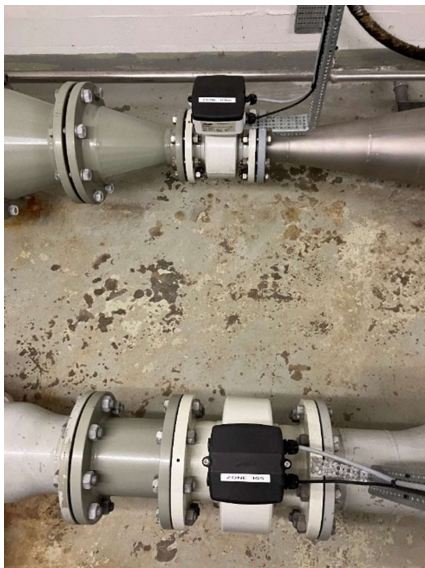
Bagerst: Udledning til z83 Forrest: Udledning til z105
