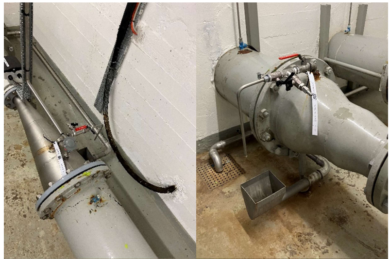
Placering af taphaner på henholdsvis udledning til z83 (venstre) og z105 (højre)
