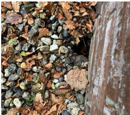
B2: Hul langs murværket, 1
