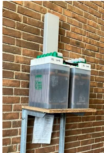
Batteri til sikring af overvågning ved strømsvigt
