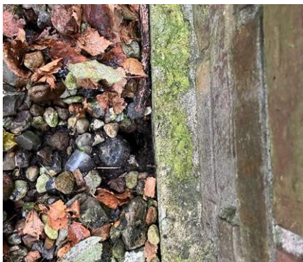
B4: Hul langs murværket, 2
