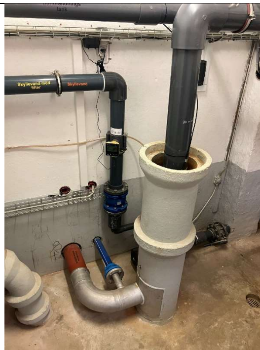
Afløb filterskyllevand mm.
