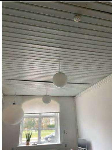
Dampa loft i mødelokale, hvor de er ved at falde ned, samt der mangler loftplader.
