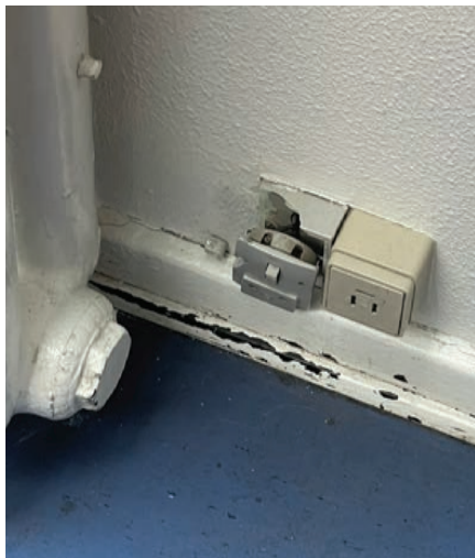
El installationer - tilstand
