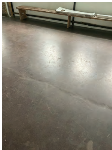
Betongulv i kælder lakeret, med revner
