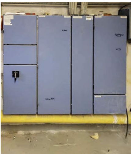
El installationer - tavler
