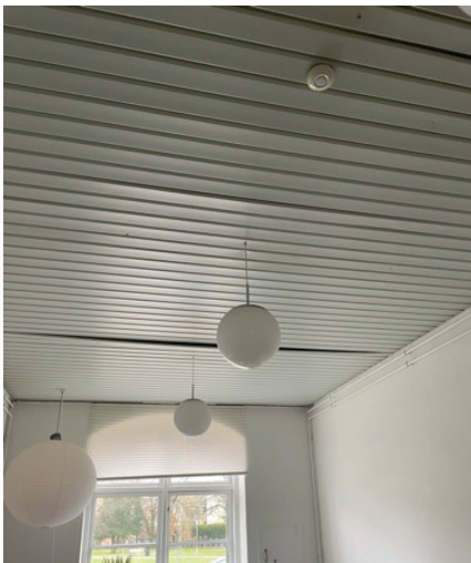
Nedhægte lofter - tilstand
