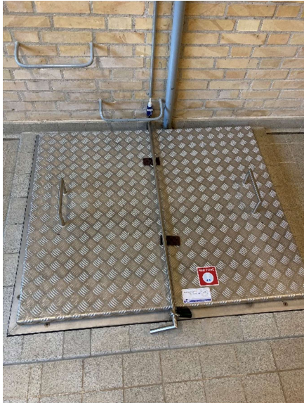
Mandehul til rentvandstank
