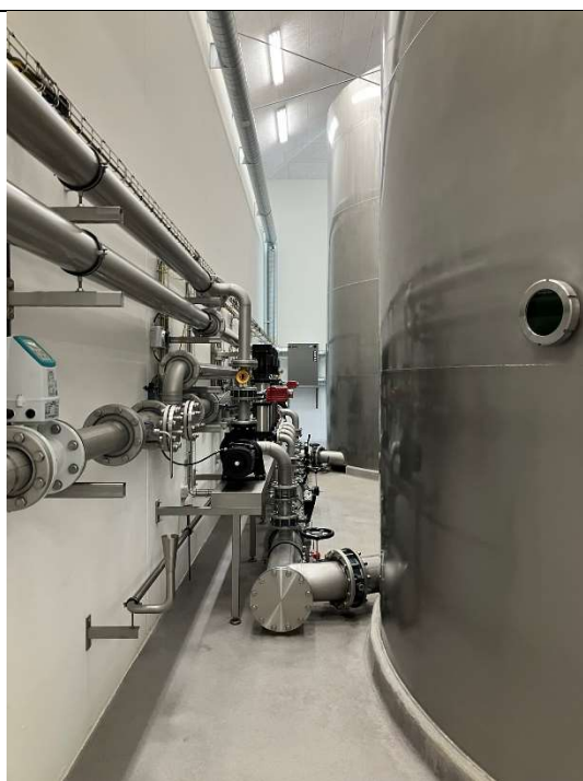
Udpumpning, afgang vv prøvehane, vandur
