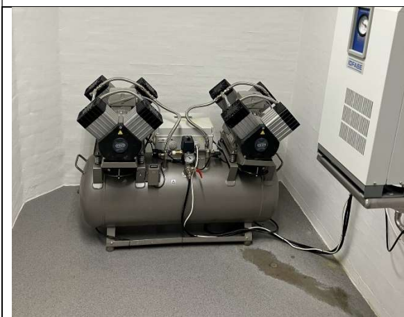
Kompressor til iltning
