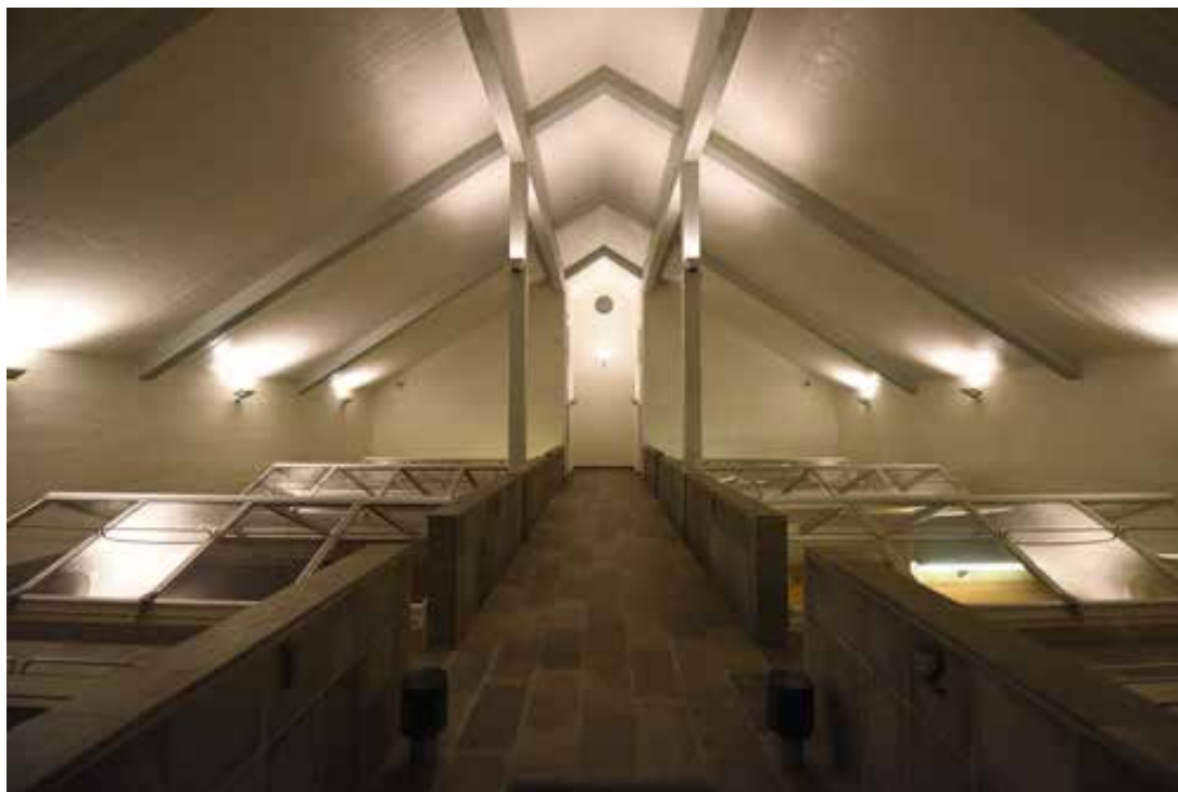
Overdækkede filtre på Åboværket, Aarhus Vand.
